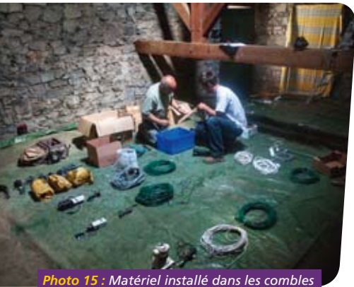
Photo 15 : Matériel installé dans les combles d'un bâtiment du Parc national des Écrins.
