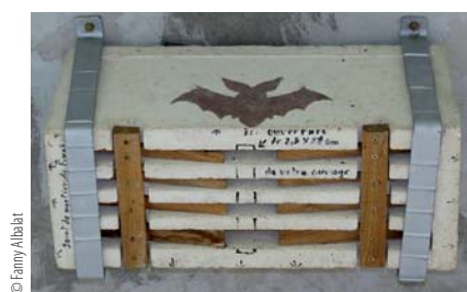
Nichoïr artificiel mis en place sous un pont.
